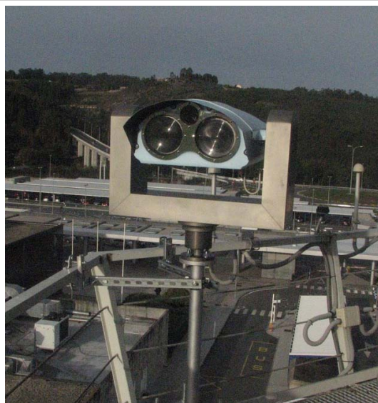
el aparato está instalado en la terraza de la torre de control
